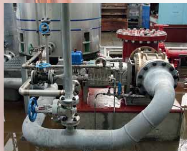
FD8000/1-PP-S в установке пенного пожаротушения для защиты морского терминала
