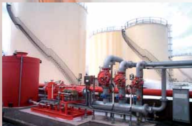
FD6000/3-PP-S в составе установки пожаротушения для защиты резервуарного парка нефтепродуктов
