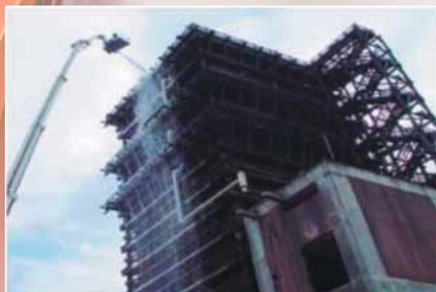
Подача готового раствора пенообразователя AFFF для работы лафетного ствола на высоту 54 м без какого-либо влияния на качество дозирования пенообразователя.
