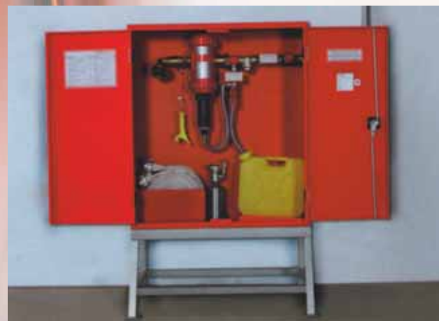
Настенный пожарный шкаф с отсеком для хранения пожарного рукава
