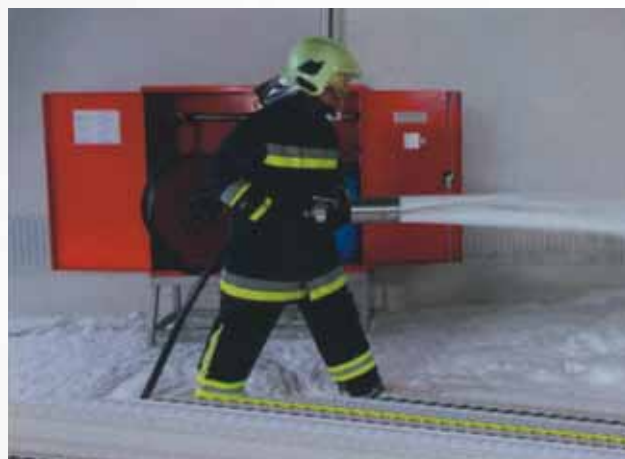
Настенный пожарный шкаф с кассетой для пожарного рукава
