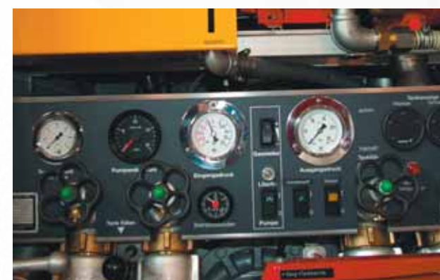
Панель управления FireDos, установленной в отсеке пожарного автомобиля
