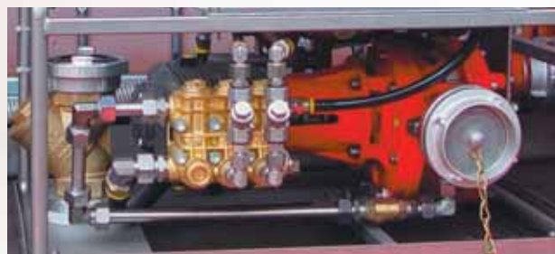
Система FireDos со ступенчатым изменением дозирования в отсеке пожарного автомобиля
